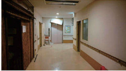
活動場所 あおば病院 エレベーター破損状況
